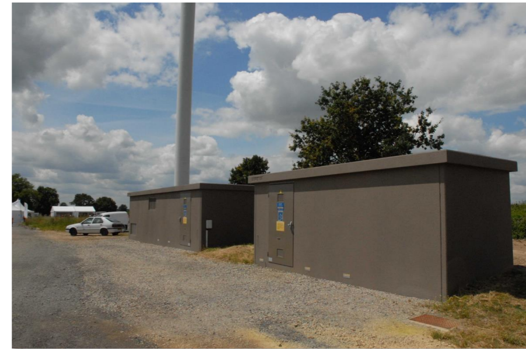
Photo 142 : Exemple de poste de livraison
